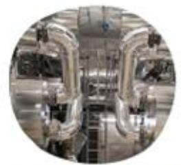
RÉCUPÉRATION CHALEUR FATALE
